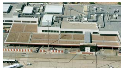
Vista aérea de las cubiertas del edificio terminal al acabar los trabajos de plantación.
